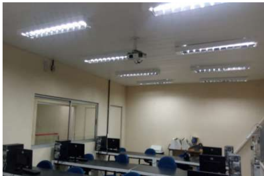
Figura 12. Imagem demonstra a visão real da sala de instrumentação com as luminárias e lâmpadas fluorescentes tubulares instaladas.
