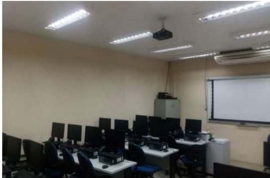
Figura 20. Imagem demonstra a visão real da sala de informática com as luminárias e lâmpadas LEDs tubulares instaladas.
