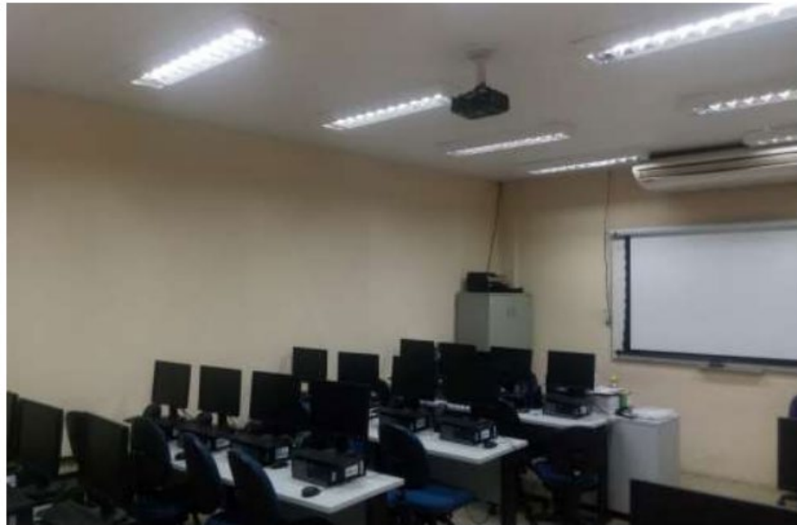
Figura 20. Imagem demonstra a visão real da sala de informática com as luminárias e lâmpadas LEDs tubulares instaladas.
