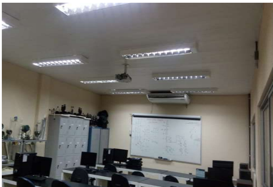
Figura 13. Imagem demonstra a visão real da sala de instrumentação com as luminárias e lâmpadas fluorescentes tubulares instaladas.
