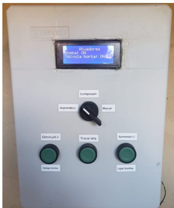
Figura 2. Quadro de comando.
